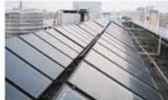
太陽熱利用設備
