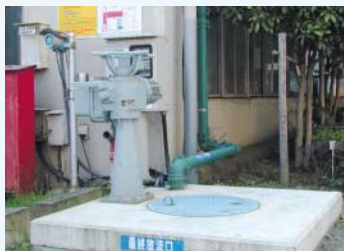
雨水異常時遮断バルブ
