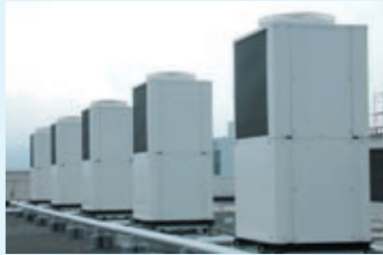
ガスヒートポンプ屋外機
