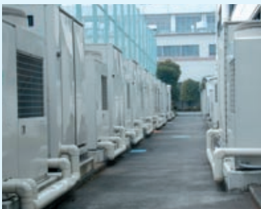
氷蓄熱システム室外機
