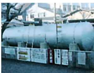
重油下段タンク
