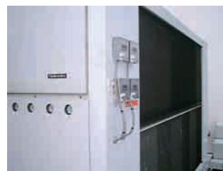
電力監視システム
