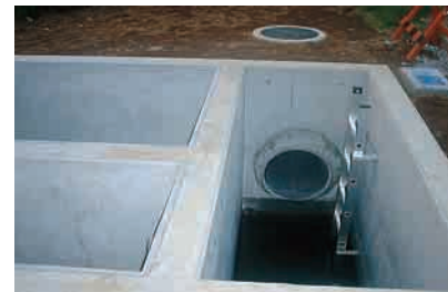
緊急対応水槽および雨水最終放流口
