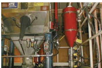
トナー供給台と新設粉塵トナー回収装置
