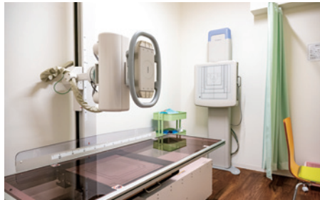
▲X線（レントゲン）撮影装置（写真）や超音波画像診断装置など、最新鋭の設備を完備
