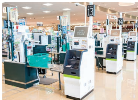
▲7レーンのうち4レーンがセミセルフレジ。高齢のお客様などに配慮し、通常のレジも設置した
